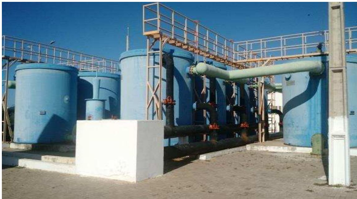
Foto 1- Filtros na Estação de Tratamento de Água de Aracati – Ceará.
